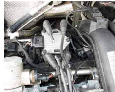
Beschädigung durch Nagetiere
